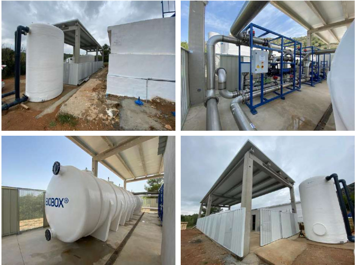
Figura 2: Imágenes interiores / exteriores de Planta de Biofiltración BIOBOX Nitratos de 120 m 3 /h (Recirculación, suministro 200 m 3 /h)
