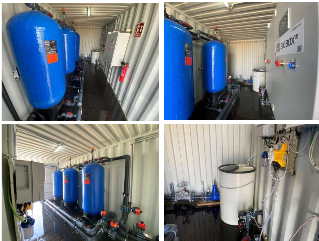
Figura 2: Fotos del interior de la planta BIOBOX turbidez 15M 3 /h
