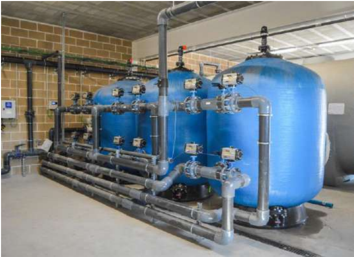
Figura 1: Planta de Biofiltración BIOBOX Nitratos de 20m 3 /h
