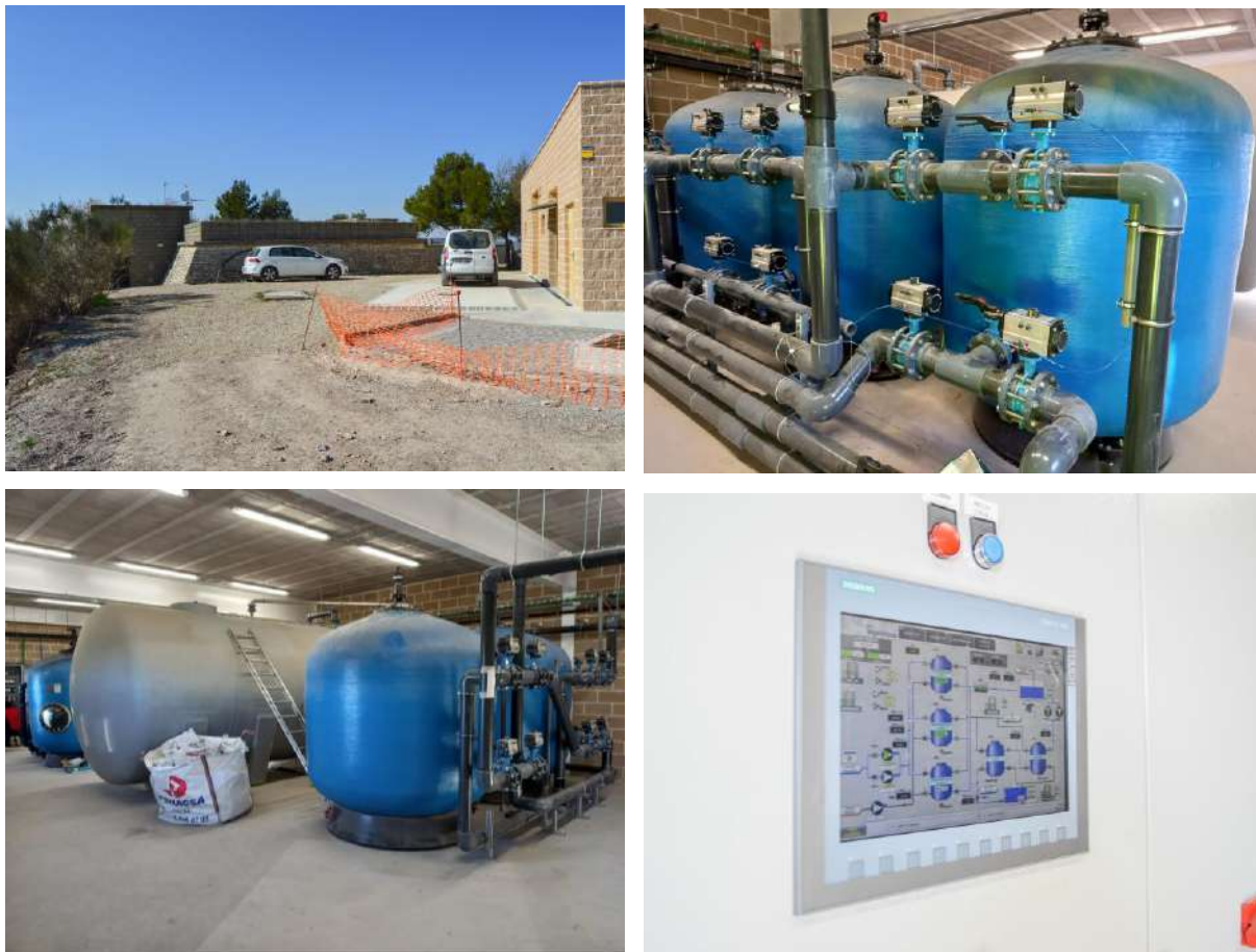
Figura 2: Imágenes interiores / exteriores de Planta de Biofiltración BIOBOX Nitratos de 20m 3 /h
