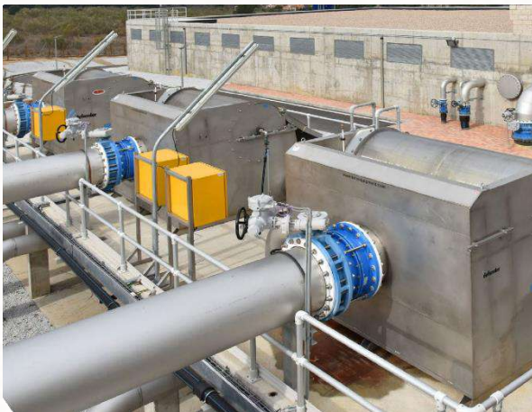
ETAP de Pelayos de la Presa; Canal de Isabel II
