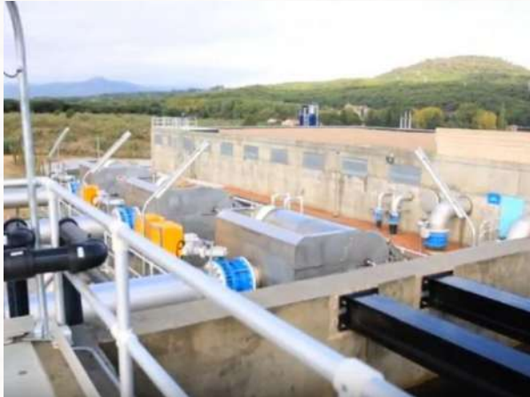
ETAP de Pelayos de la Presa; Canal de Isabel II
