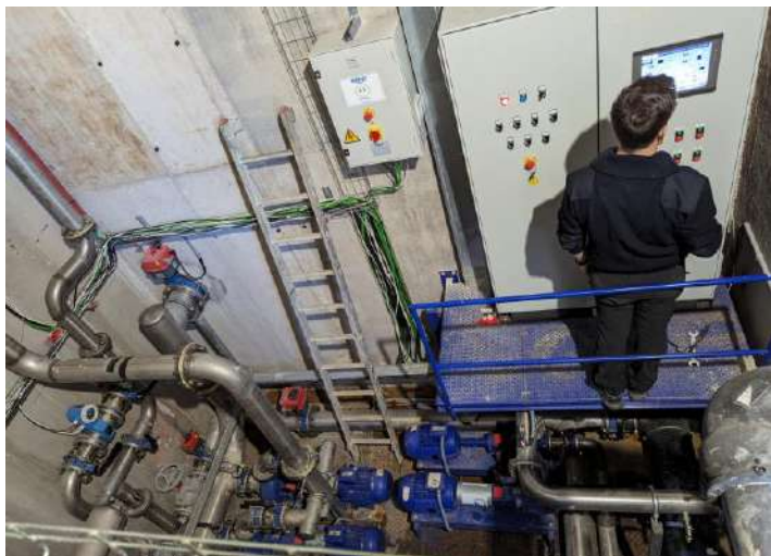
Figura 1: Planta de Biofiltración BIOBOX Nitratos 65 m³/h
