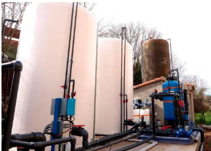
Figura 1: Planta de Biofiltración BIOBOX Nitratos de 20m³/h
